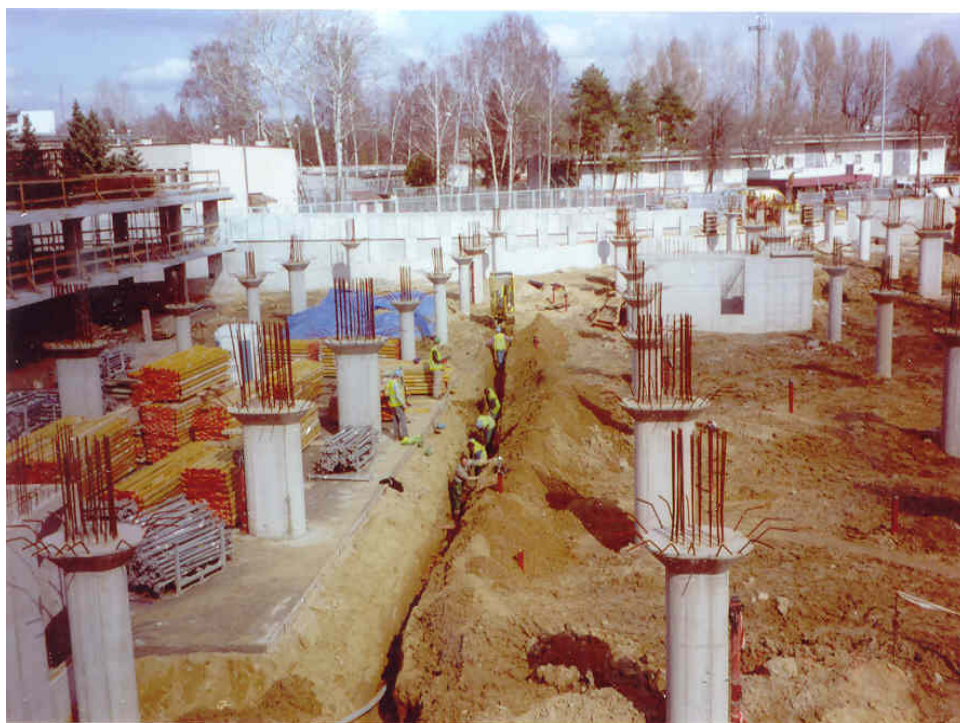
1. Brak zabezpieczenia wykopu wąskoprzecznego.
