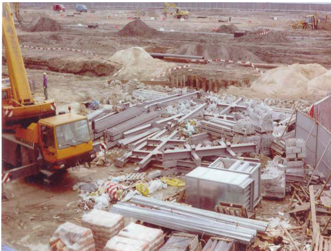
3. Niewłaściwe składowanie wyrobów budowlanych. Brak barier ochronnych wykopów.
