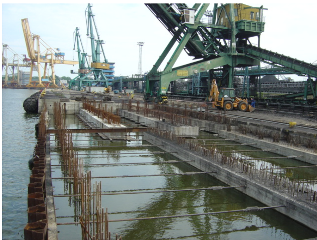
4. Brak barier ochronnych przy budowie nabrzeża.
