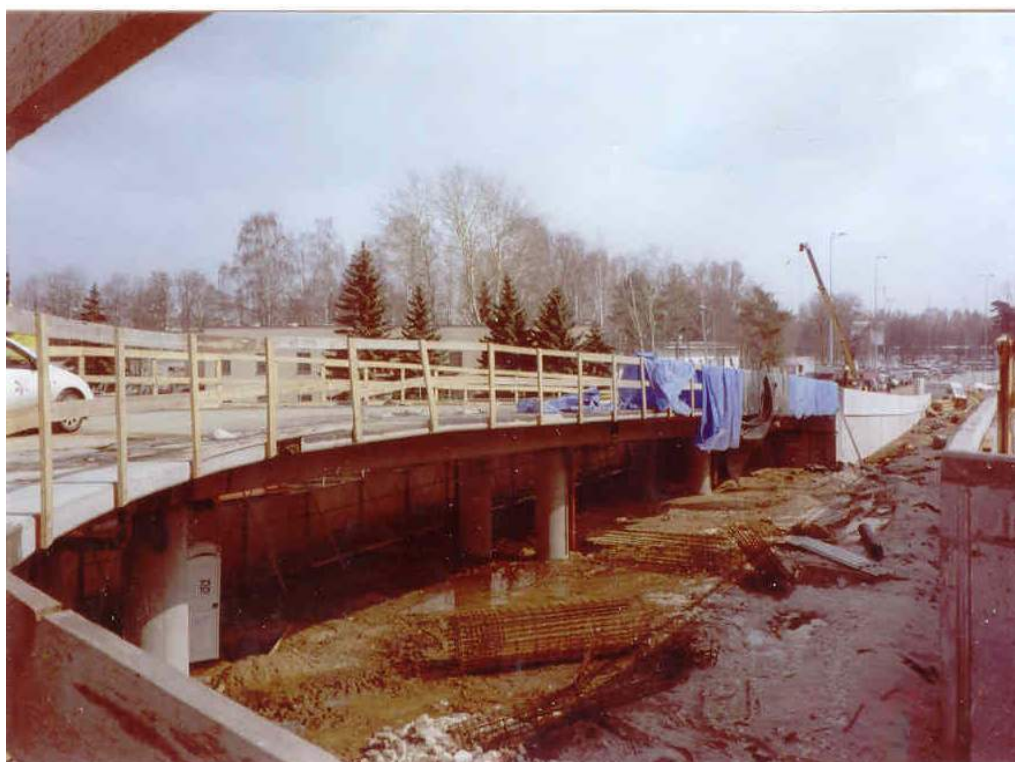
2. Nieprawidłowo składowane zbrojenie.
